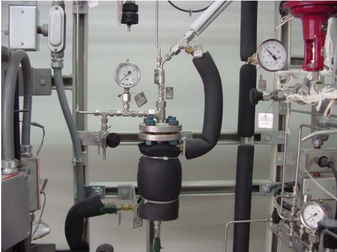
Figura 07 – Segundo separador da unidade de separação da planta GTL
