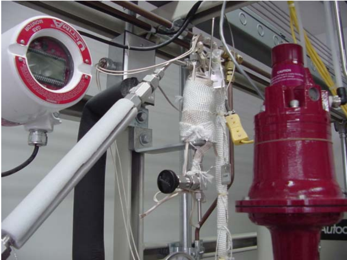
Figura 04 – Primeiro separador da unidade de separação da planta GTL
