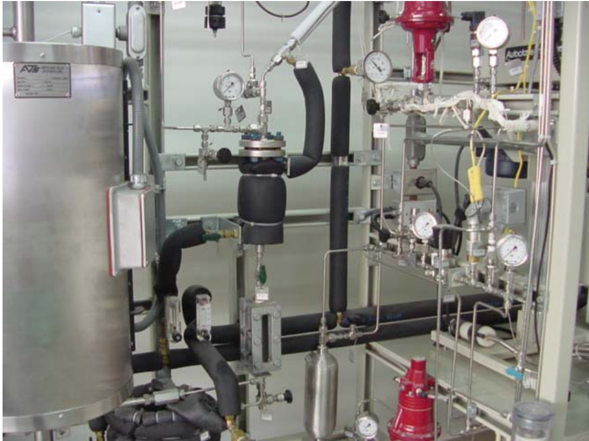
Figura 08 – Segundo separador da unidade de separação da planta GTL
